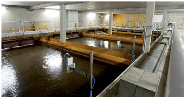
Usine de pompage et de traitement d'eau potable de Lorgies
