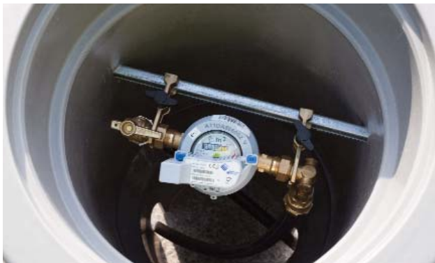
Fosse à compteur neuve
